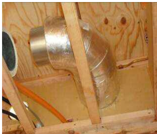
①壁面-ダクト接続
