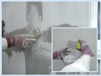
4. ドクター-Qリペアーの粉末を水分を含ませたスポンジ等を使用し、補修面に練り込むようにすり付ける(すり込み式)。
