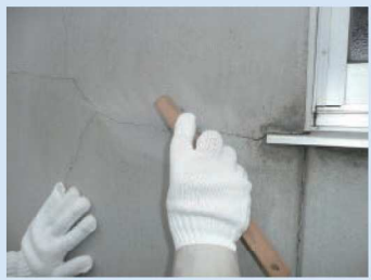
2. クラック・ピンホール補修面をワイヤーブラシ等でケレン清掃する。
